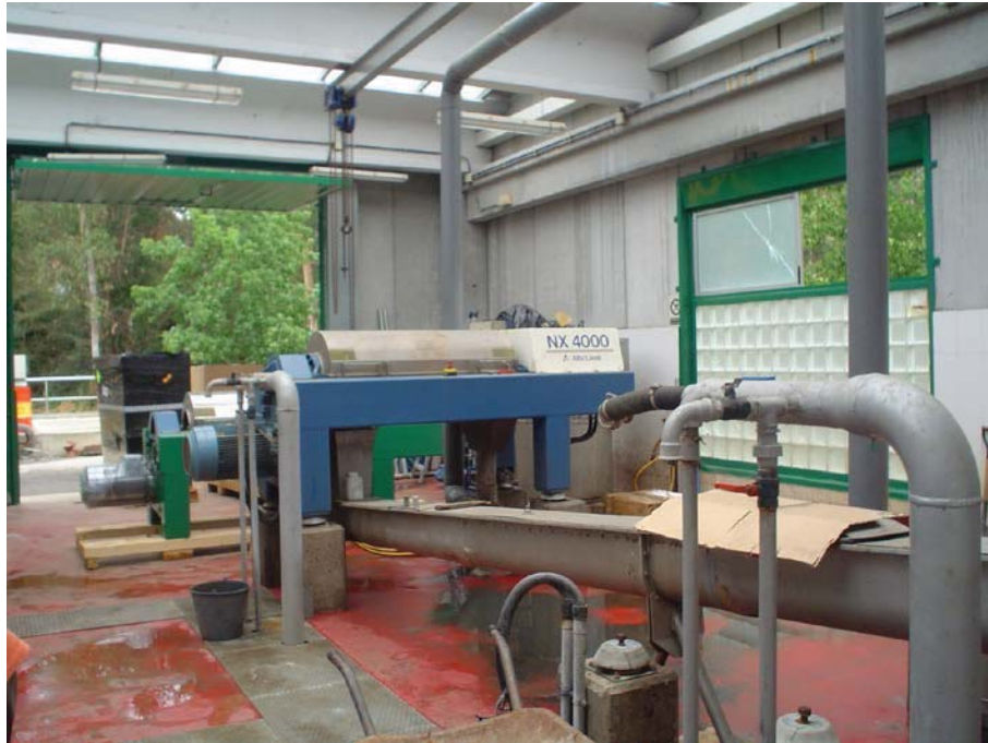
Fotografia 13. Sala de deshidratació de fangs
