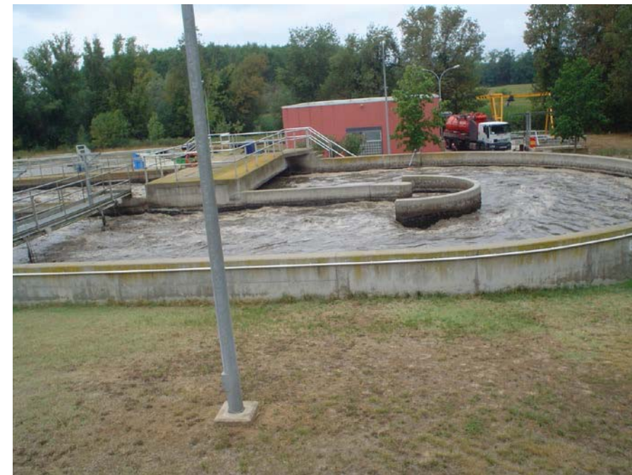
Fotografia 4 Reactor biològic existent
