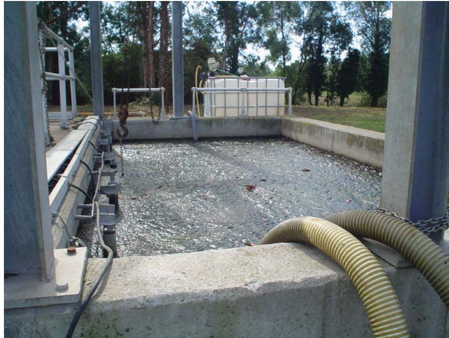
Fotografia 9 Arqueta de recirculació i purga
