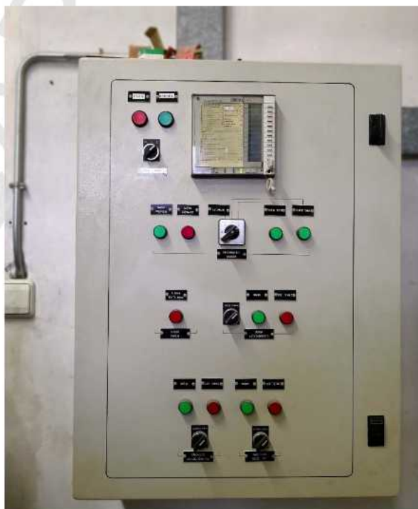
Fig. 9. Quadre de control de la sala de calderes del CEIP Puig d'Arques
