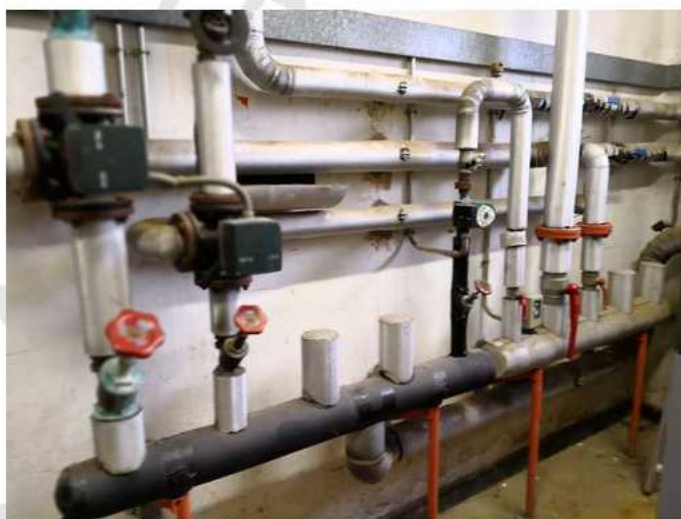
Fig. 3 . Col·lectors d'impulsió i retorn del CEIP Puig d'Arques
