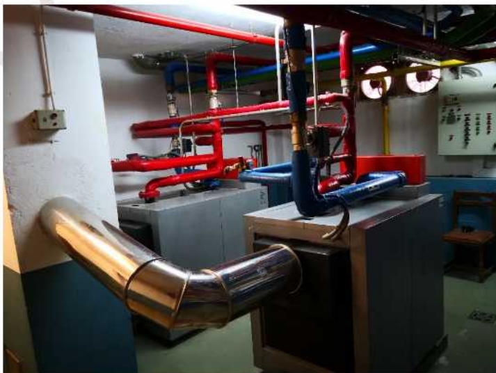
Fig. 4. Vista interna de la sala de calderes, de l'Hospital Geriàtric
