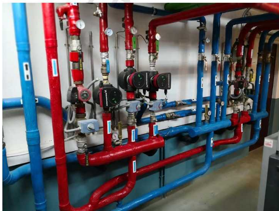
Fig. 2 . Col·lectors d'impulsió i retorn de l'Hospital Geriàtric Sant Josep
