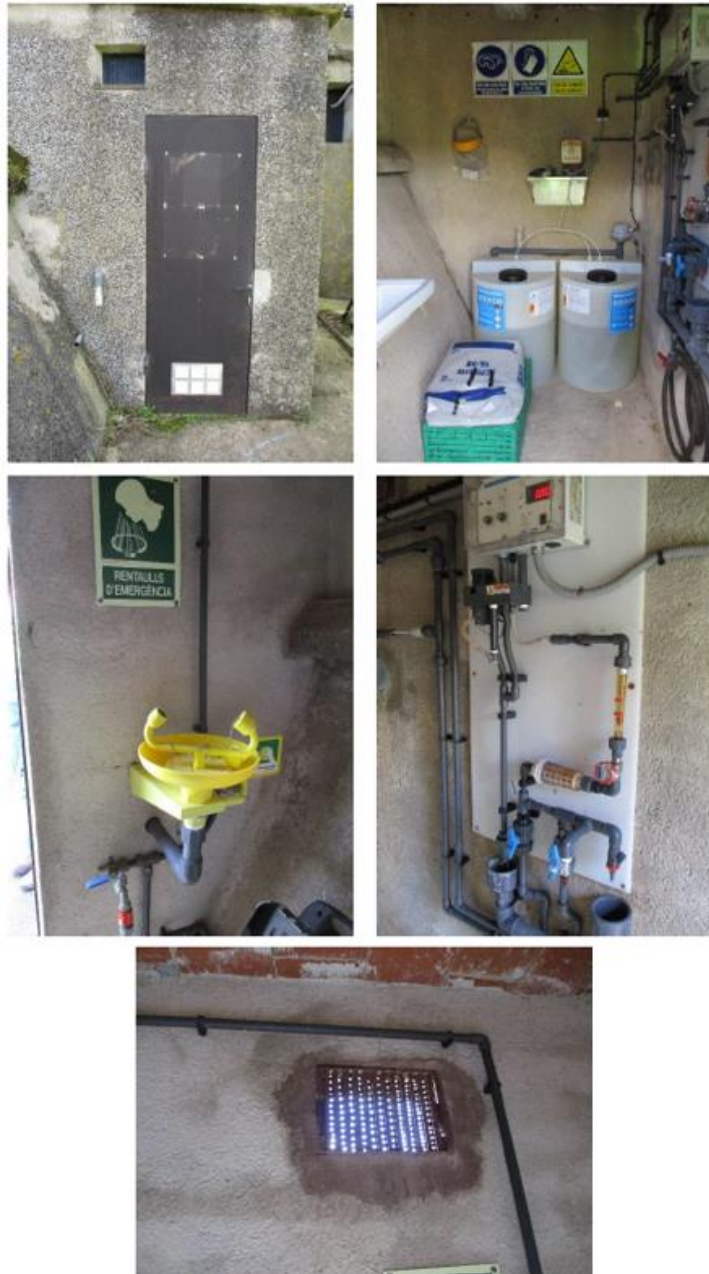
Figura 32. Dipòsit Vell: sala d'emmagatzematge i dosificació d'hipoclorit sòdic
