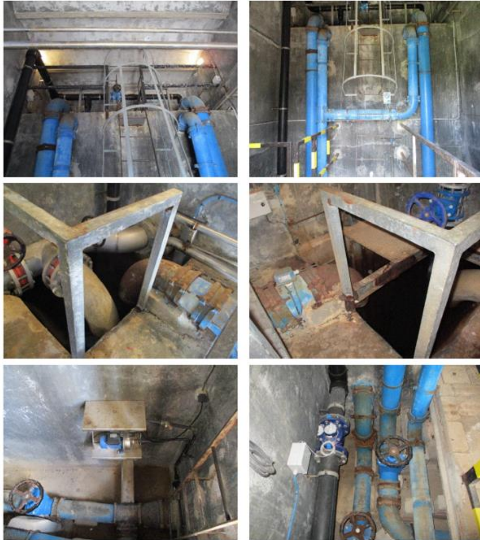
Figura 36 Dipòsit Nou: cambra de claus i accés vasos
