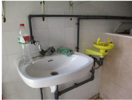
Figura 28. ETAP Dipòsit Nou: sala d'emmagatzematge de reactius
