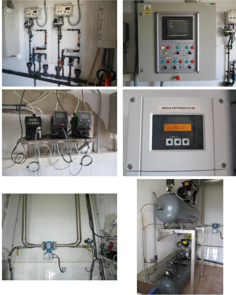
Figura 27. ETAP Dipòsit Nou: mesuradors en línia i bombes dosificadores
