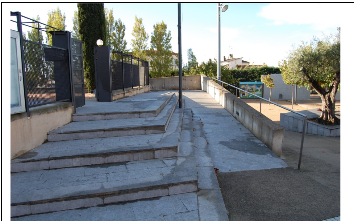
Foto 02 - Rampa accés principal - Es requereix la col·locació d'una segona barana
