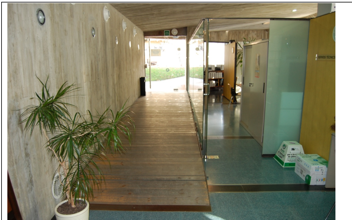
Foto 03 - Rampa interior - Falten passamans als dos costats, pendent correcte
