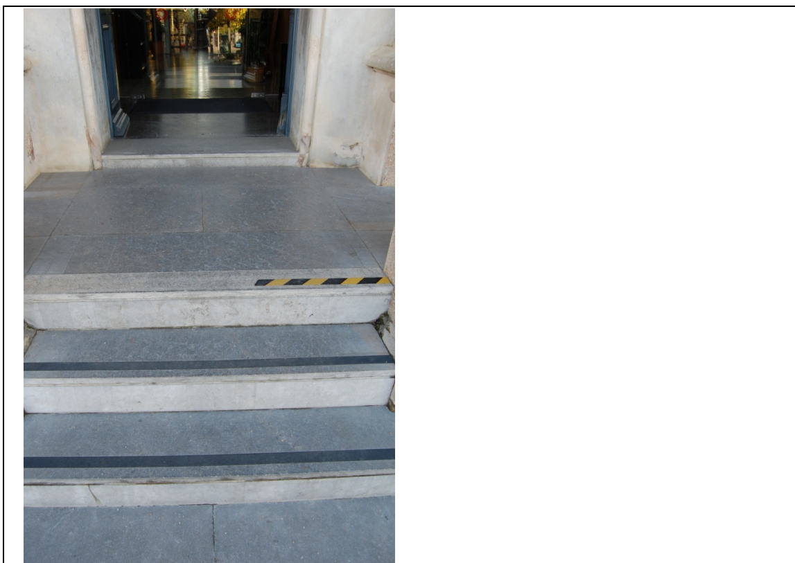
Foto 04 - Porta principal - Existeix un petit graó just a la porta d'entrada d'uns 10cm
