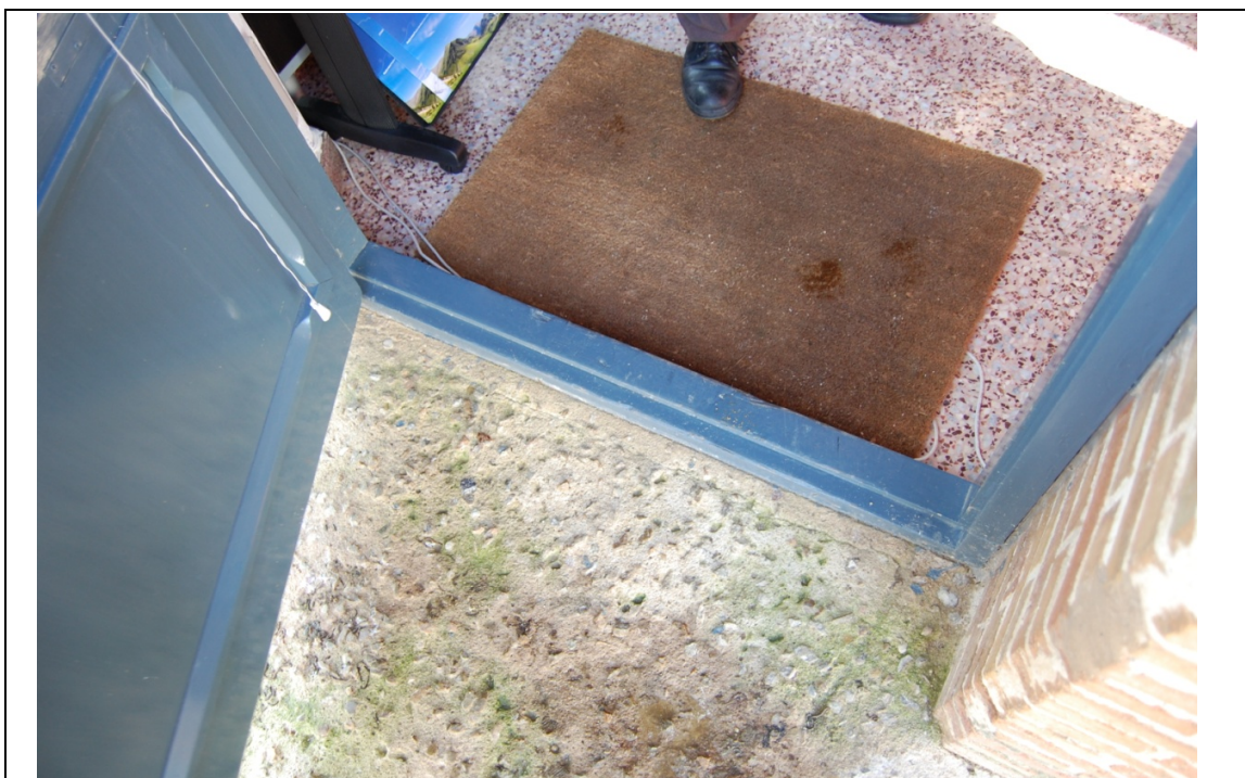
Foto 02 - Vista porta d'entrada - Travesser inferior del bastiment
