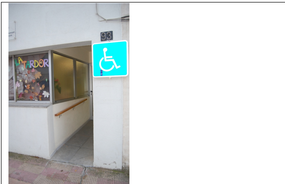
Foto 02 - Rampa accés principal - Només disposa d'un passamà
