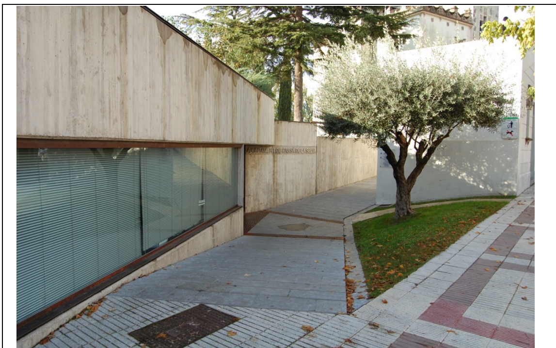
Foto 02 - Rampa accés principal - Es requereix la col·locació de baranes als dos costats
