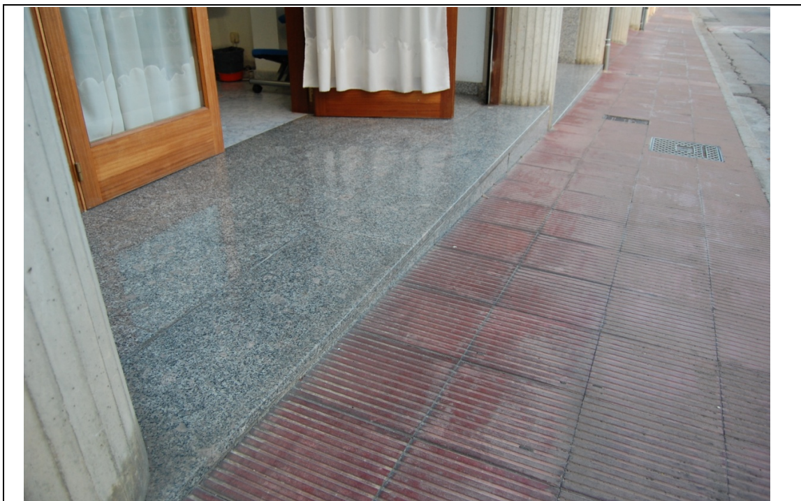
Foto 03 - Graó existent a l'accés
