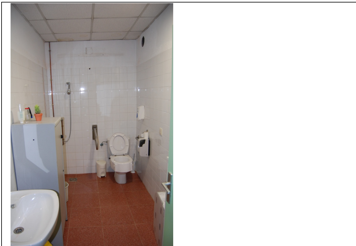
Foto 04 – Vista cambra higiènica – No hi ha espai de transferència lateral
