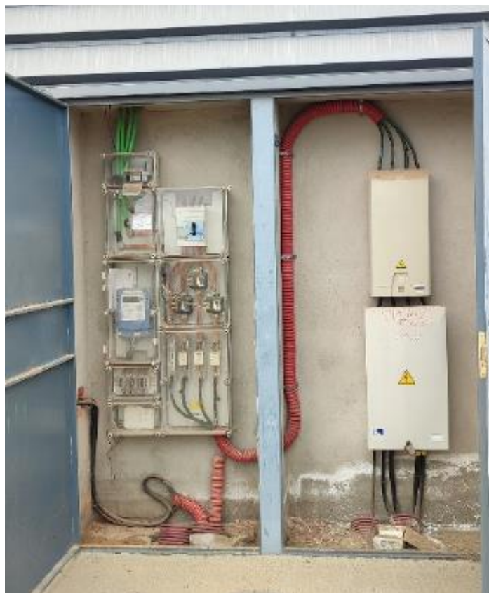
Figura 14. Zona CGP existent
