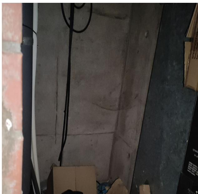
Figura 7. Espai lliure a la sala tècnica per la col·locació d'elements elèctrics.
